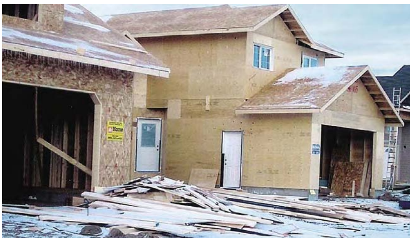
La construction de maison sur le site engendre une quantité considérable de déchets
